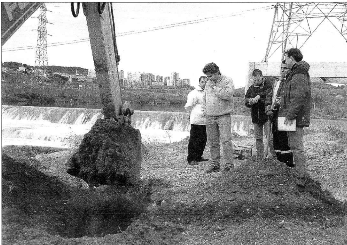
Aquest mes ja s'han fet les primeres prospeccions per comprovar el nivell de contaminació de les lleres. Foto: D. SAURA RAMIRO.
